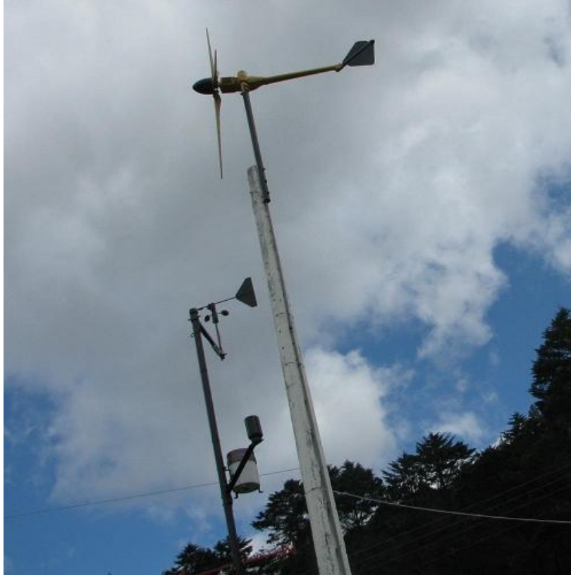
Figura 48. Detalle del aerogenerador y estructura de soporte.
