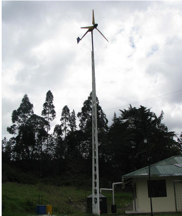
Figura 51. Detalle del aerogenerador, estructura de soporte y casa sostenible.
