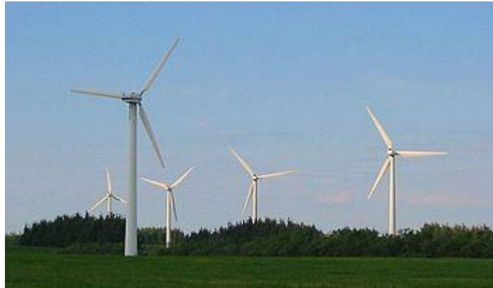
Figura 1. Parque eólico compuesto de varios aerogeneradores.
