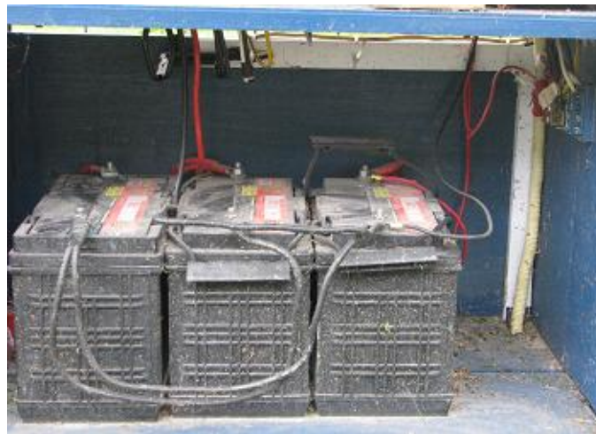
Figura 47. Detalle de conductores de corriente continua instalados.
