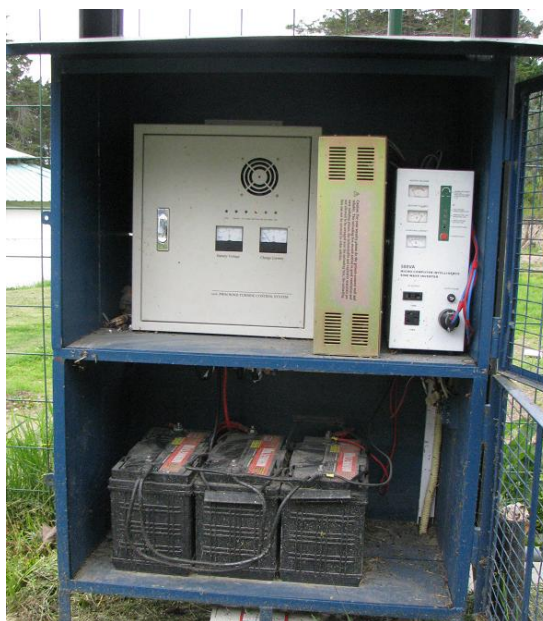
Figura 53. Detalle de equipos de control de carga y descarga de energía, banco de baterías e inversor.
