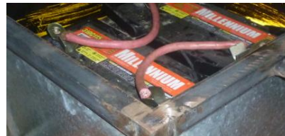
Figura 40 baterías de gel de 120 Ah
