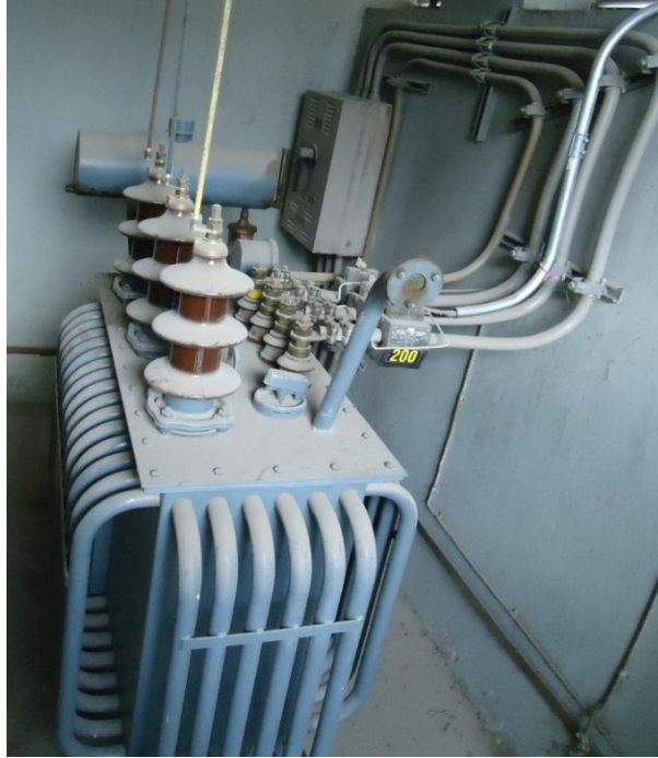
Figura 27. Transformador de 100 kVA existente en el hospital
