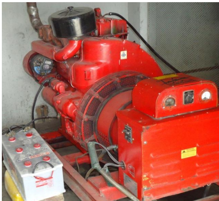
Figura 28. Generador auxiliar de 20 kVA
