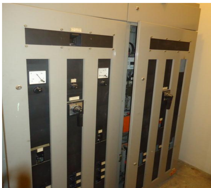
Figura 29. Tablero general de distribución
