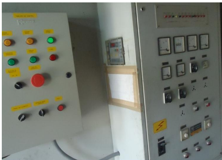
Figura 30. Tablero de transferencia automática
