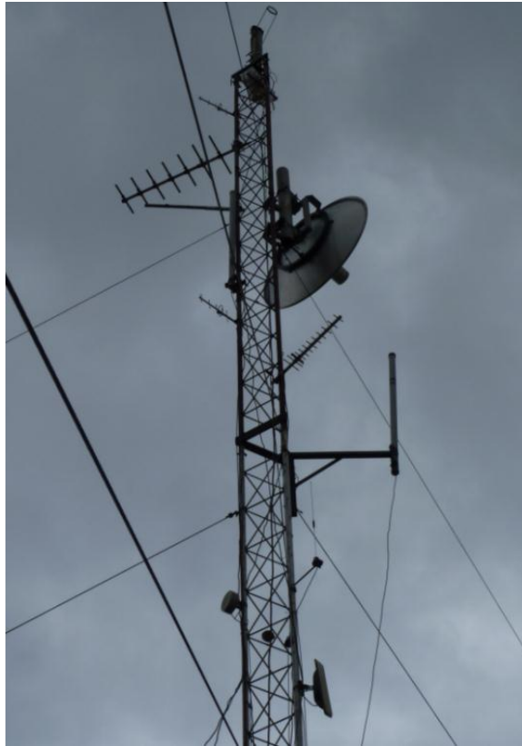
Figura 3.18. Torre para ubicar los equipos de STL.
