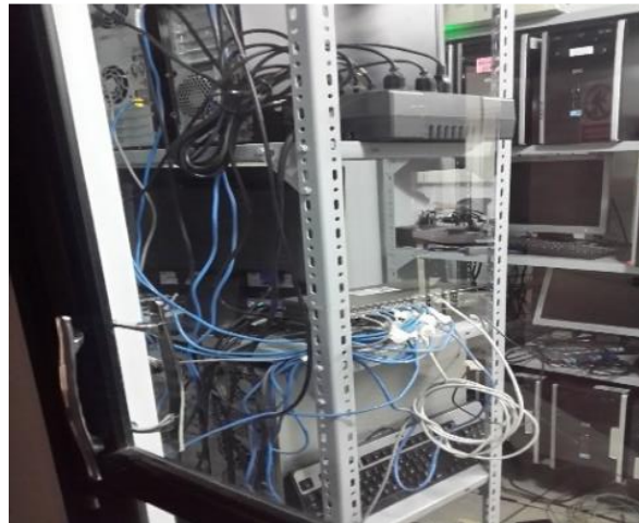
Figura 21. Cableado en los Armarios
