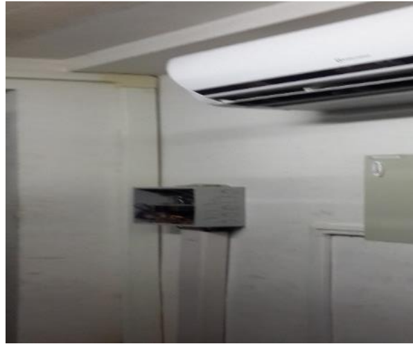
Figura 22. Cableado en Canaletas
