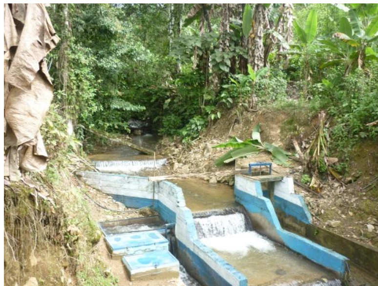
Figura 7. Sistema de Captación Namacuntza, que provee de agua a la ciudad de El Pangui.
