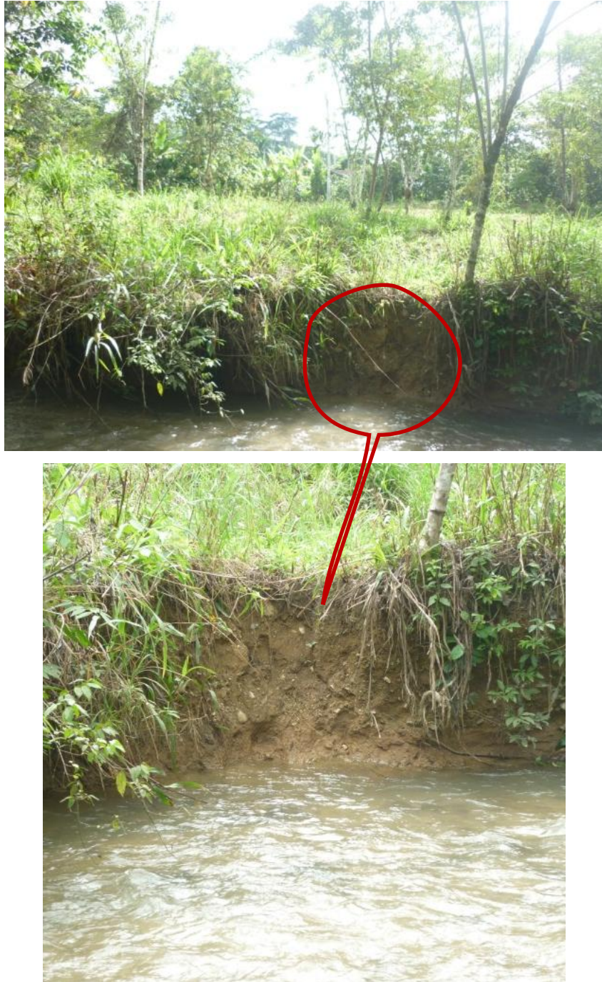
Figura 12. Orillas inestabilidad, erosión en las curvas (socavadas) por la alteración de la zona ribereña.
