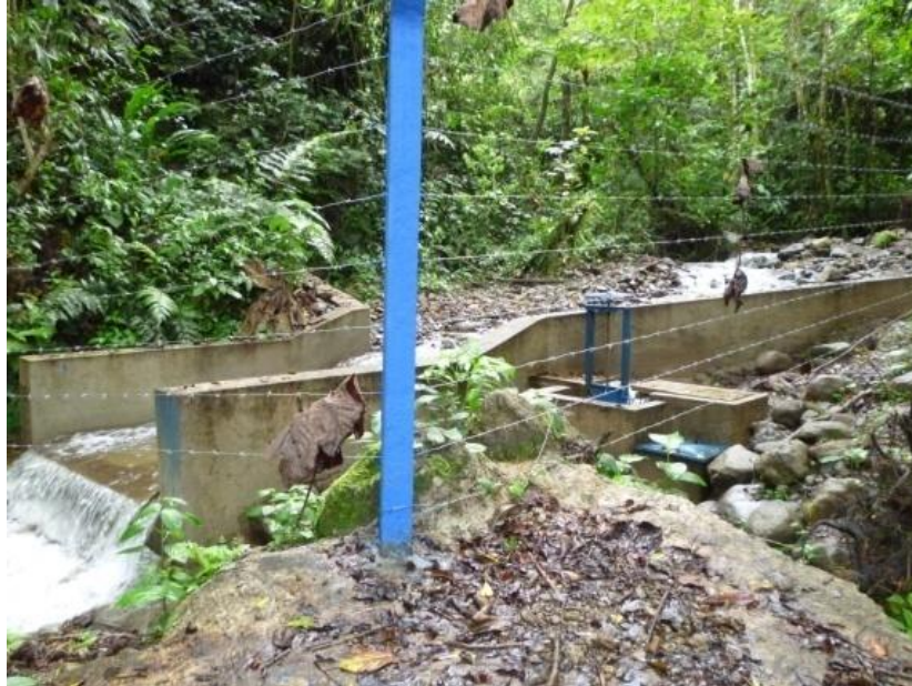
Figura 4. Sistema de Captación Cayamatza, que abastece de agua a las comunidades Pashkus, Charip y Michanunka.
