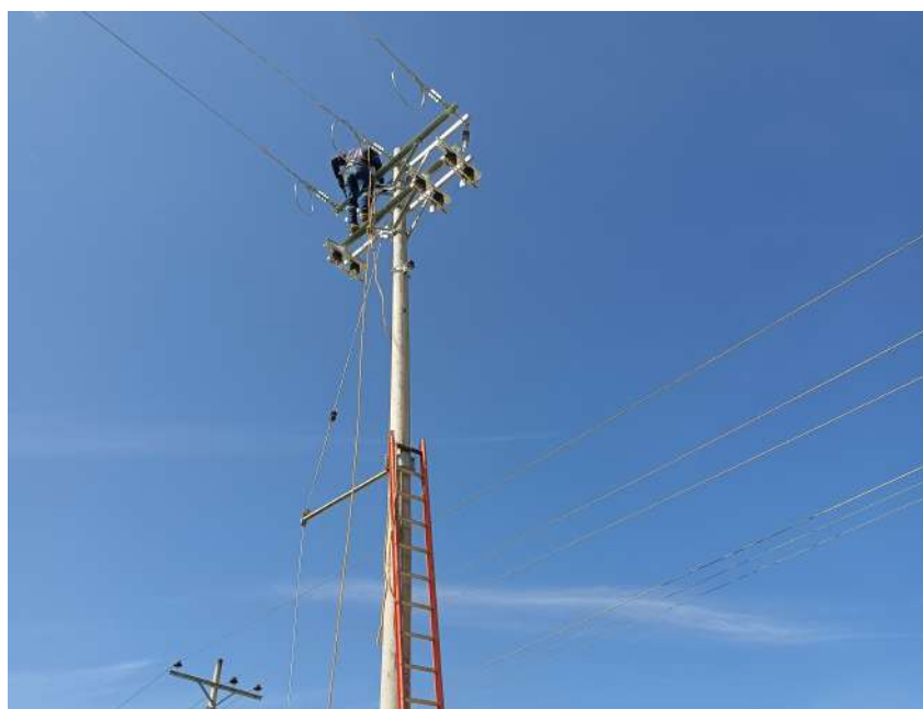
Figura 7. Red de media tensión aérea trifásica
