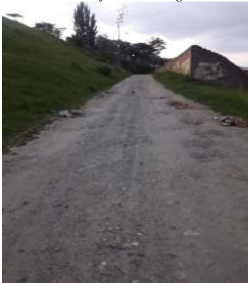
Calle sin asfaltado
