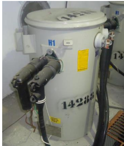
Figura 12 Transformador convencional con frente muerto
