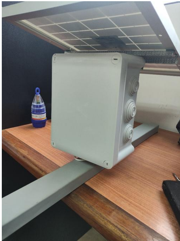
Figura 46. Ubicación del tablero de control
