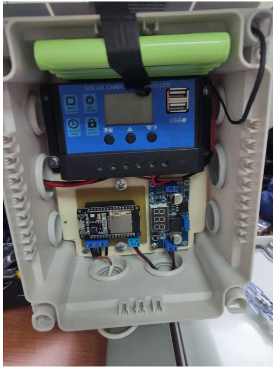
Figura 84. Ubicación de dispositivos en el tablero de control
