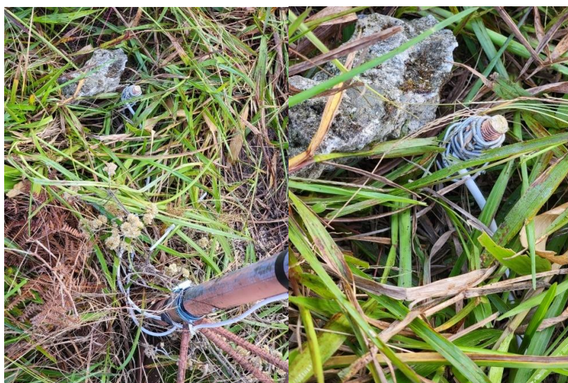
Figura 31. Puesta a tierra en el cerro Chivato.
