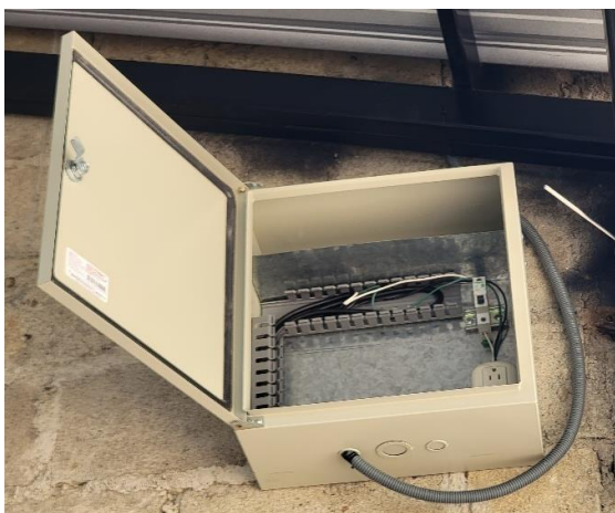
Figura 24. Caja de equipos y punto eléctrico sector Guadalupe.
