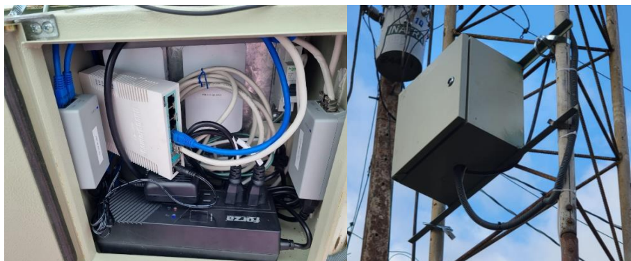
Figura 30. Caja de equipos y punto eléctrico en el cerro Chivato.
