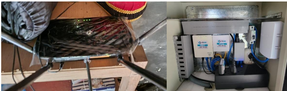
Figura 27. AP local y disposición final de la caja de equipos.
