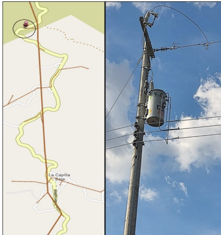
Figura 19. Localización del tercer transformador
