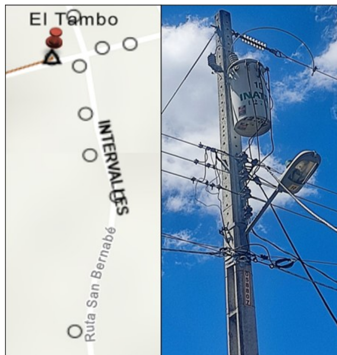
Figura 17. Localización del primer transformador
