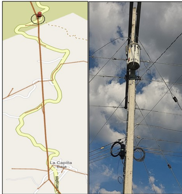
Figura 18. Localización del segundo transformador
