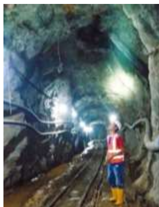
Figura 46. Iluminación del Socavón Principal
