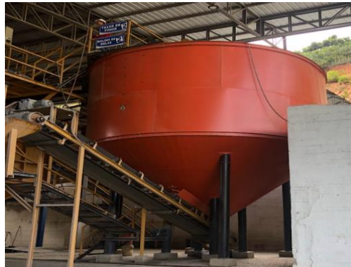
Figura 38: Tolva de Finos 2 tipo cilíndrica de 190 Ton
