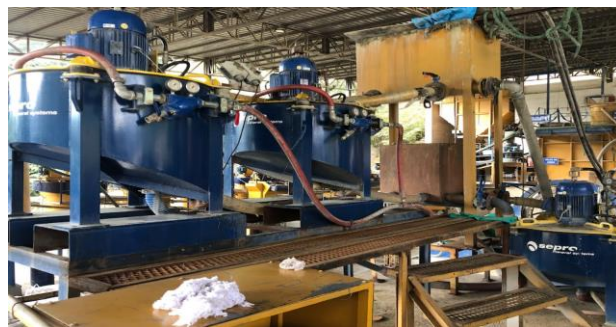
Figura 41: Sistema ICON conformado por 3 concentradores Falcon
