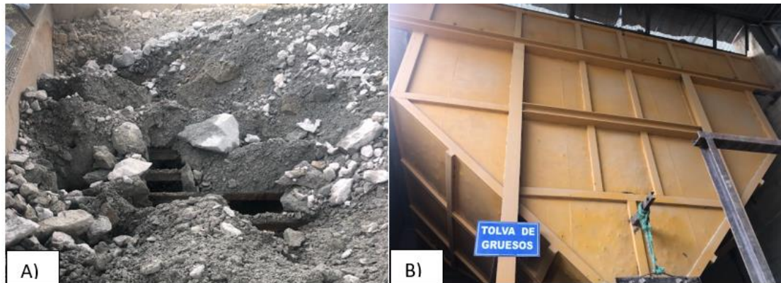
Figura 35: A) Criba fija con separación de 40 cm ubicados en la parte superior de la tolva de gruesos. B) Tolva de gruesos de 210 Ton
