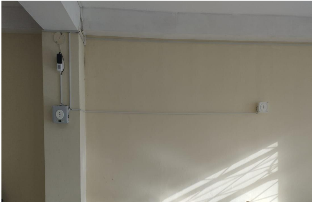
Figura 52. Implementación de sistema de control en el aula A312.
