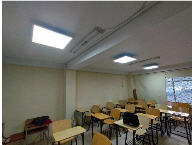
Figura 50. Sistema de iluminación implementado en el aula A312.
