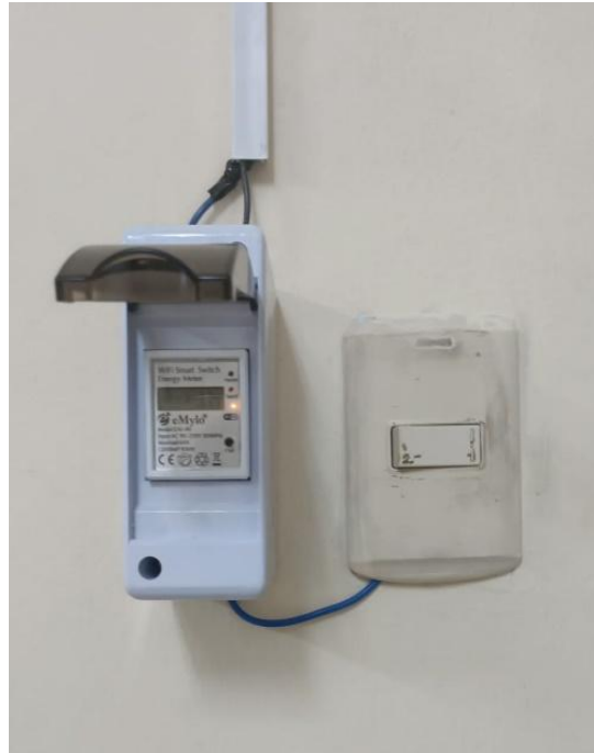
Figura 48. Medidor inteligente eMylo instalado.
