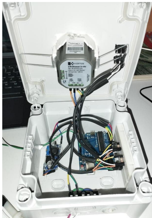
Figura 45. Cableado interno de SCAI.
