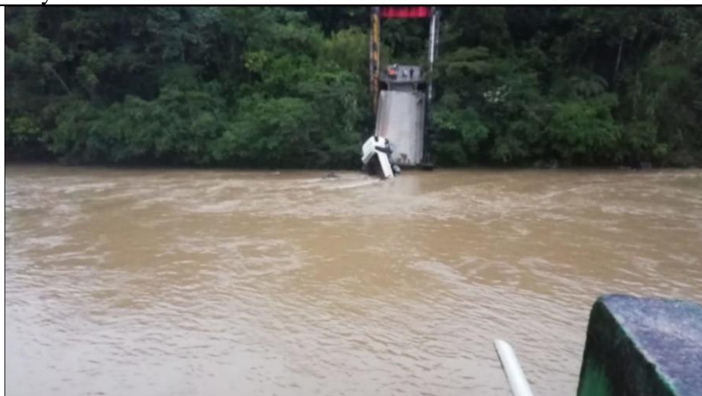
Puente caído de la parroquia Los Encuentros
