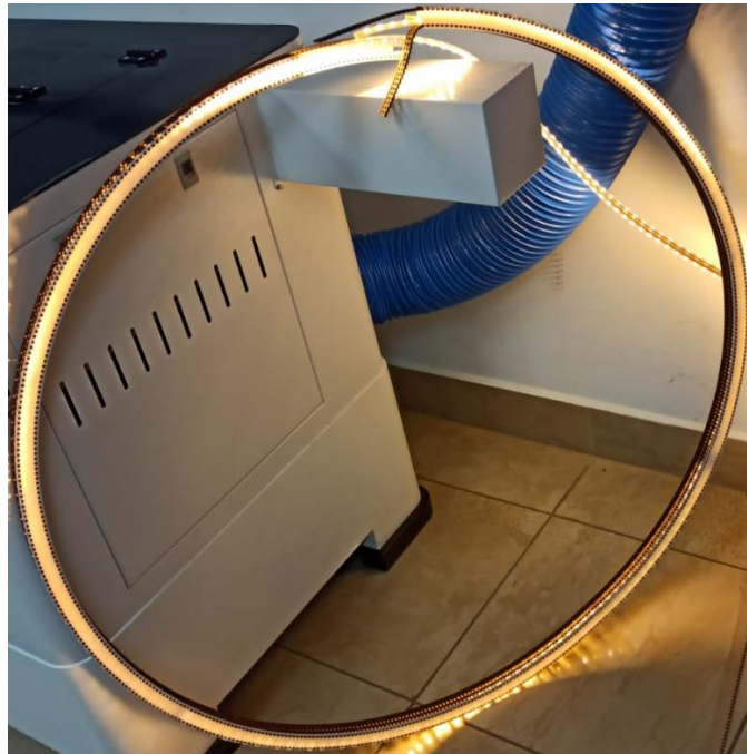
Figura 28. Manguera LED 3000k dentro del anillo circular
