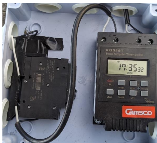
Figura 59. Conexión del breaker y el timer a la línea de corriente y voltaje
