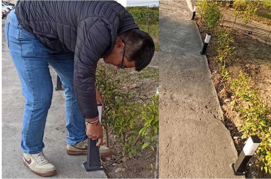
Figura 69. Luminarias de piso tipo poste instaladas
