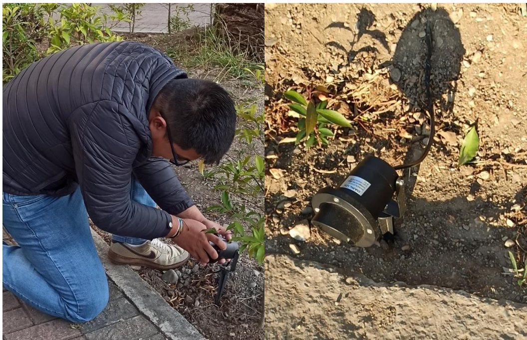
Figura 68. Luminaria de piso tipo estaca instalada
