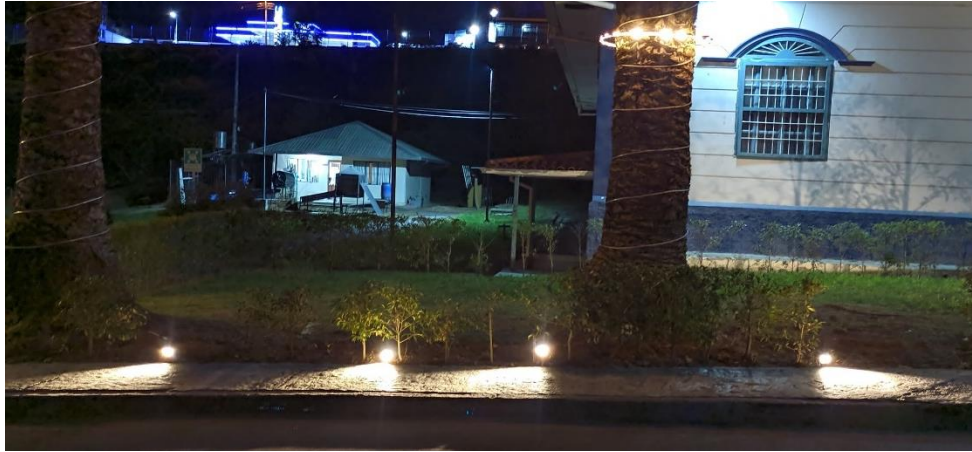
Figura 71. Luminarias de piso tipo estaca encendidas
