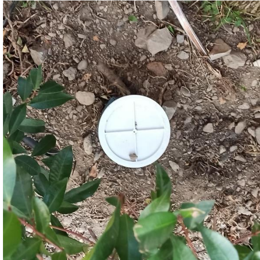
Figura 73. Punto de acceso para revisión de empalmes y derivaciones
