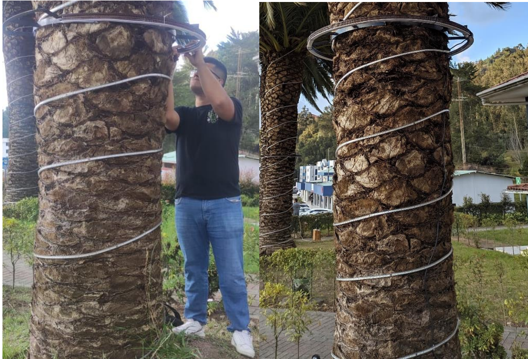
Figura 67. Luminaria circular con soporte de anillo de hierro instalada en la palmera
