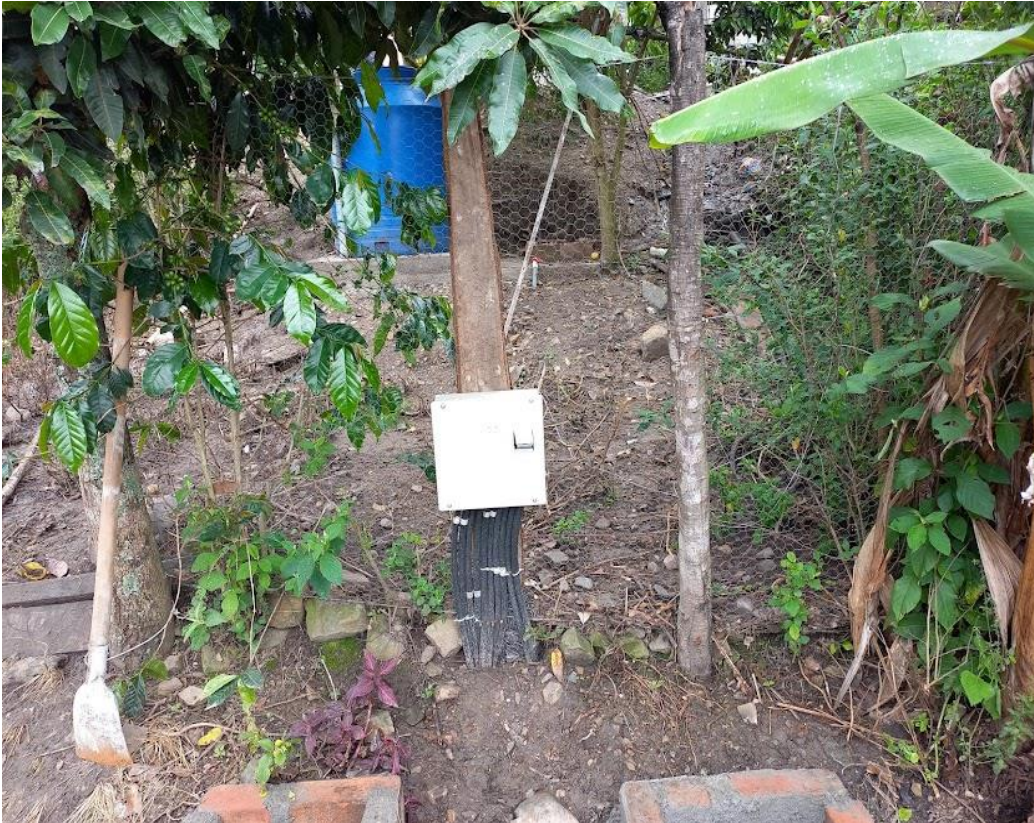
Caja de control del sistema de riego
