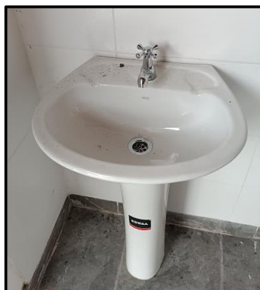
Figura 17. Lavabo de Baños Para Personas con Capacidades Especiales
