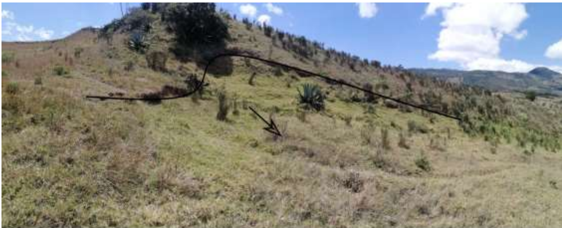
Figura 54. Deslizamiento rotacional III. Nota. Ruiz Escovar (2023)
