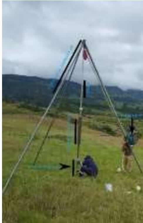
Figura 19. Equipo de sondeo de penetración estándar SPT, el cual permite realizar perforaciones e identificar la litología subterránea de la zona de estudio.
