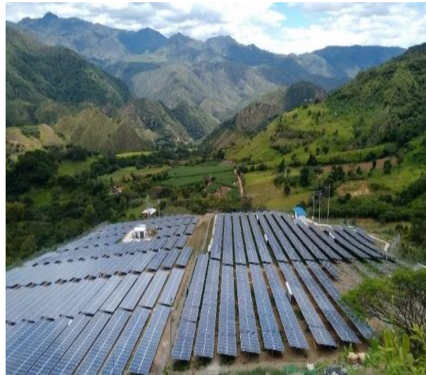
Figura 6. Parque solar Loja Energy
