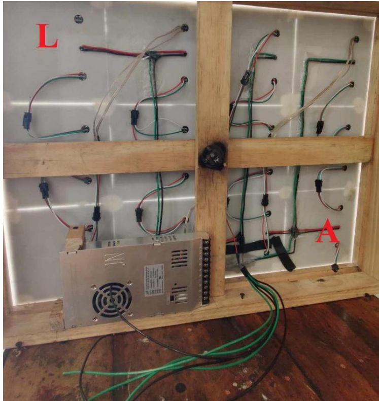
Figura 29. Sistema de energía; Distribución, salida de cables y colocación de fuente de poder.
