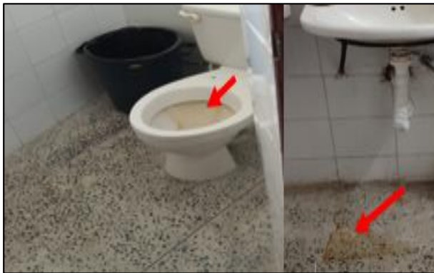
Servicios higiénicos en condiciones no adecuadas
