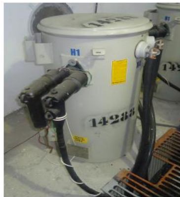
Figura 21. Transformadores convencionales con frente muerto
