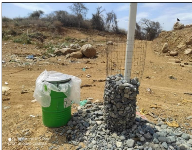
Figura 29. Sistema de tratamiento de gases producidos en el vertedero controlado
