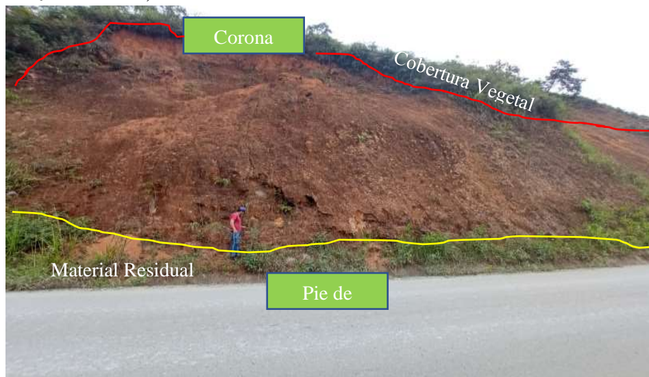
Figura 54 Deslizamiento D2, ubicado en la absc 1+389
