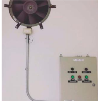
Figura 24. Sistema de ventilación con un ventilador axial.
