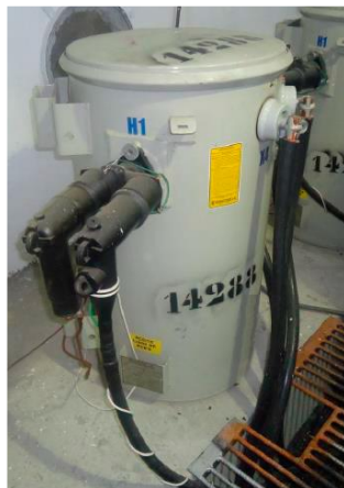
Figura 47. Transformador convencional con frente muerto.
