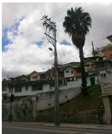
Figura 51. Transición aérea – subterránea.
