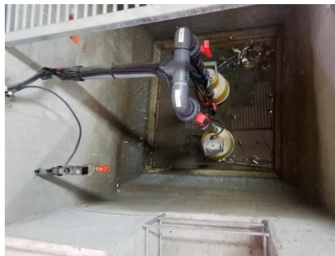
Figura 25. Sistema de drenaje con bombas sumergibles.
