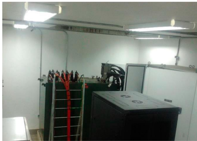
Figura 26. Iluminación interior de la cámara eléctrica.
