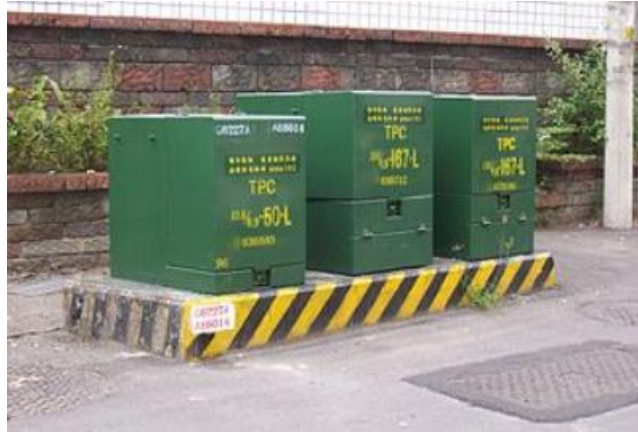
Figura 45. Transformador tipo pedestal.
