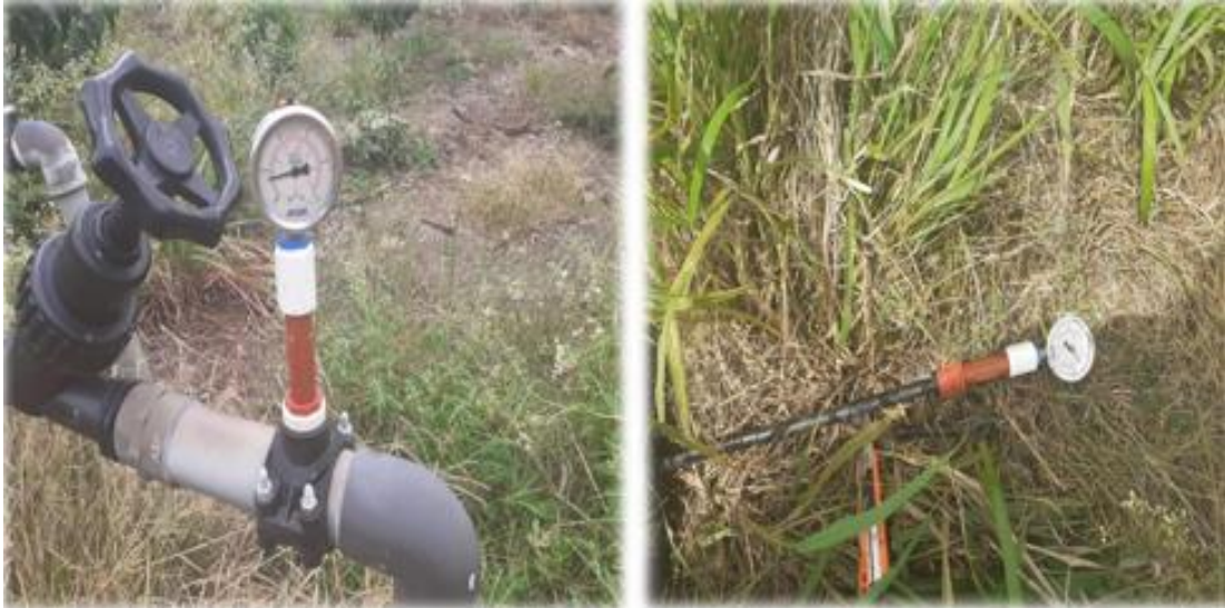
Figura 16. Toma de presión con el manómetro.
