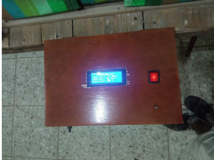
Cajas de control del sistema de temperatura en funcionamiento.
