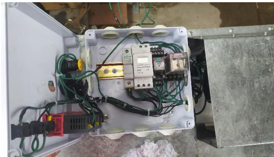
Figura 98. Conexión de tablero de control para el fermentador.
