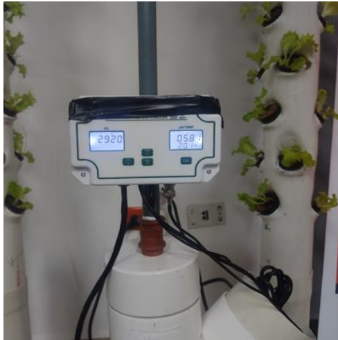
Instalación del monitor de parámetros de la solución nutritiva
