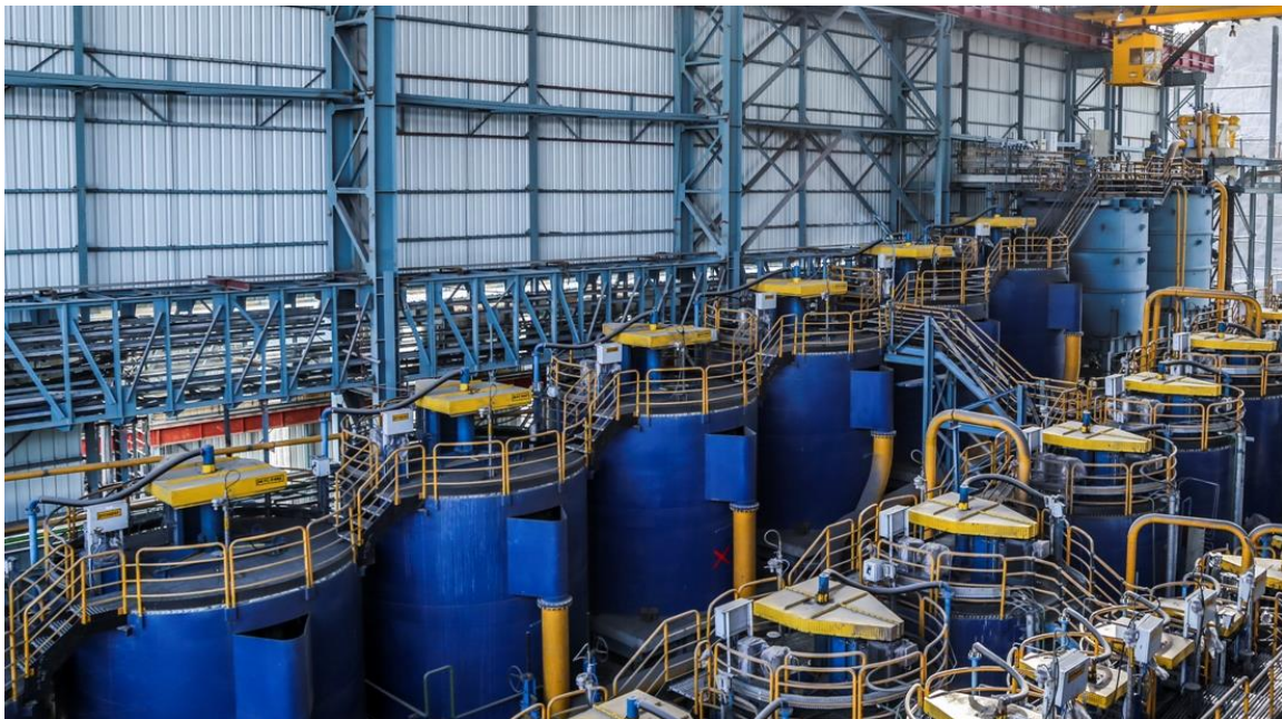
Figura 3. Banco de celdas de flotación.
