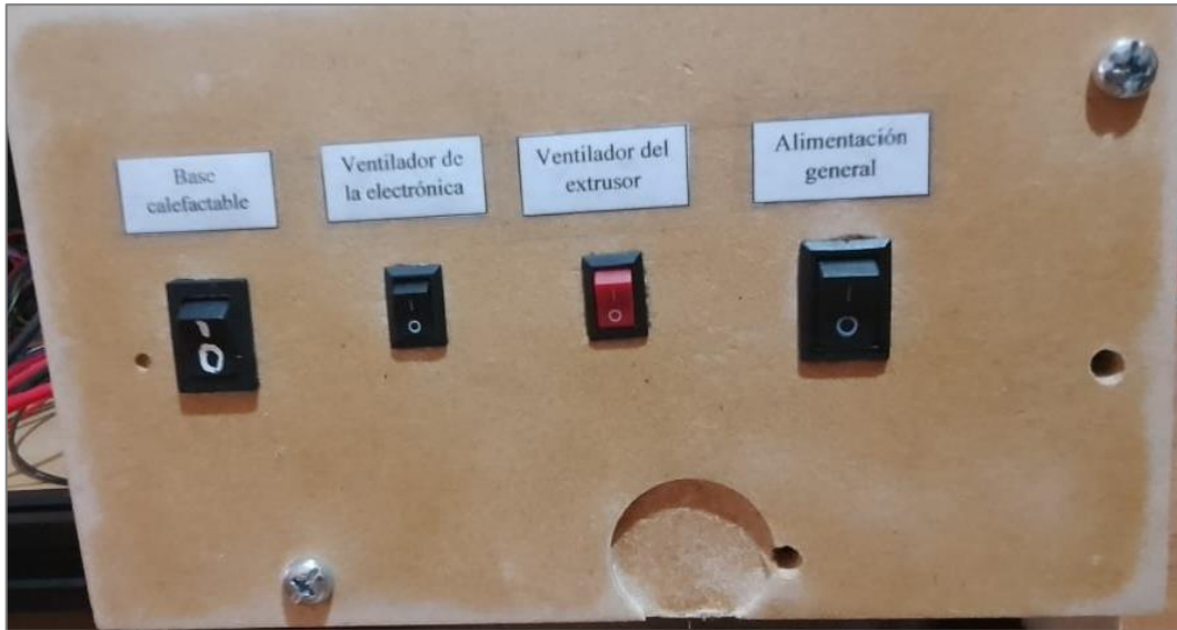
Figura 122. Interruptores con su respectiva señalización del elemento a controlar.
