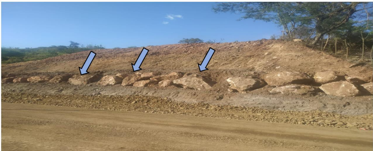
Figura 51: Etapa final rotacional y planar del deslizamiento
