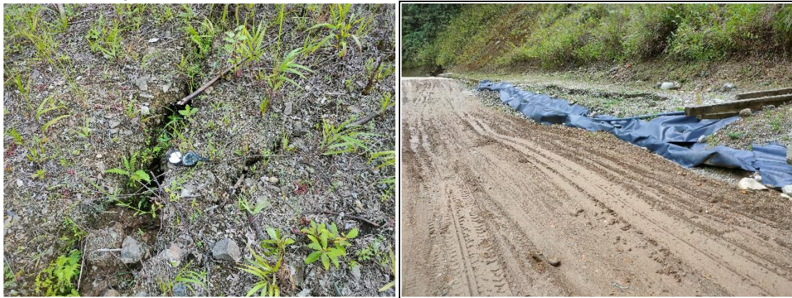
Figura 28. Grietas de tensión y corona del deslizamiento de Ventana 3
