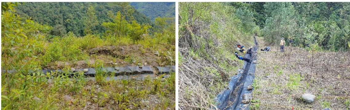
Figura 29. Cunetas de drenaje colapsadas con abundante cobertura vegetal de la Zona de Ventana 3
