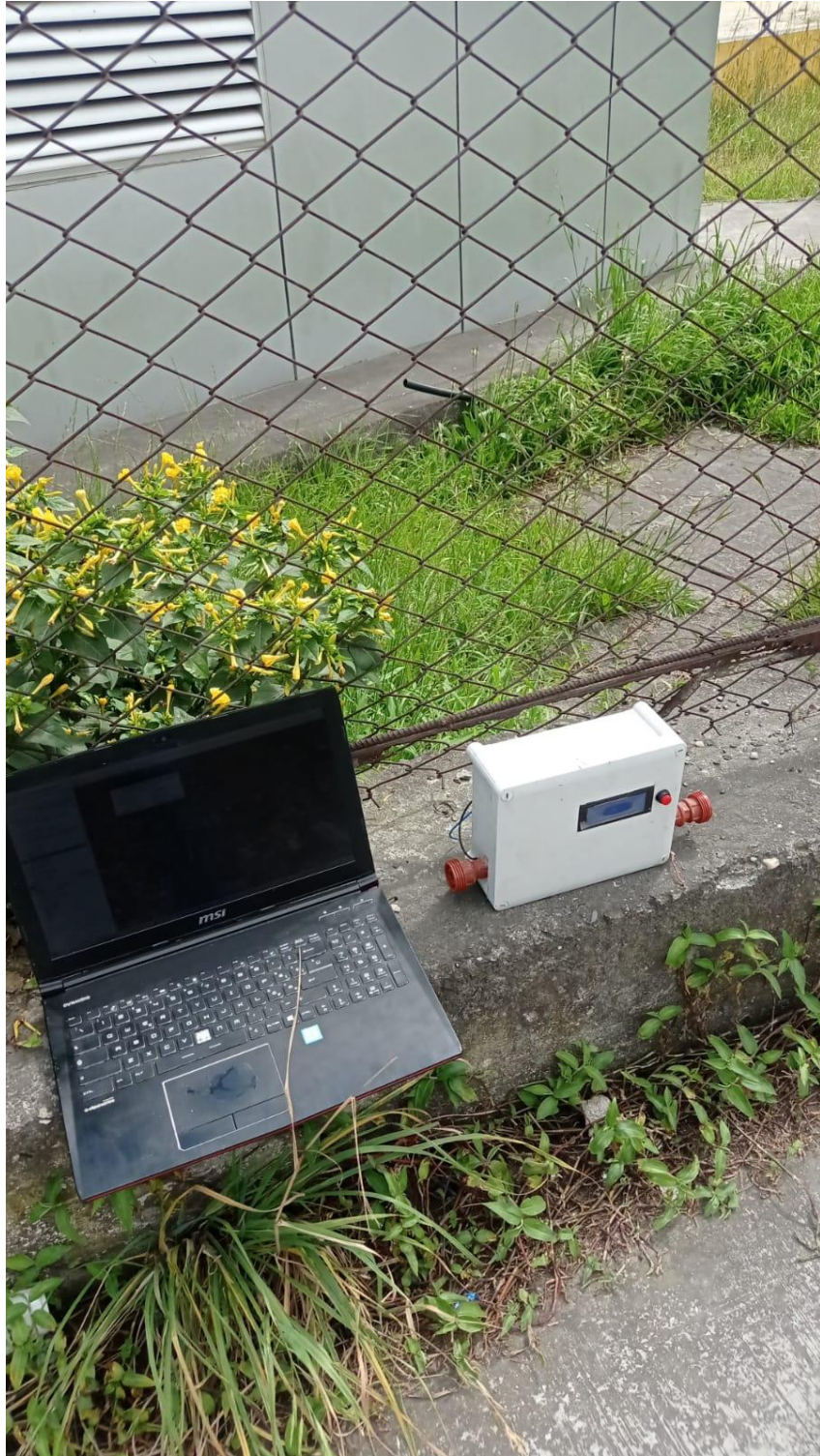
Medidor de agua transmitiendo datos desde el hospital Isidro Ayora
