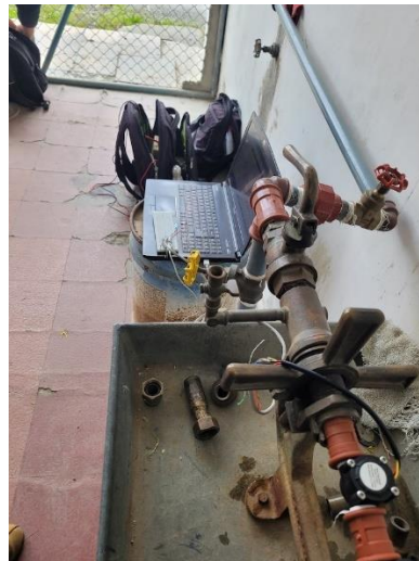
Figura 57 Sensor de flujo YF-S201 conectado a la tubería del laboratorio
