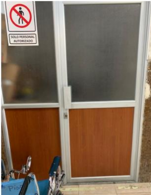
Figura 14 Entrada al Centro de Datos
