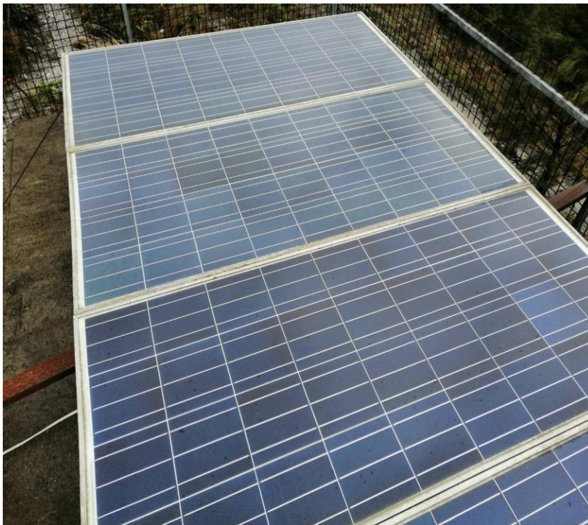
Figura 9 Banco de paneles solares para mantener operativo el equipamiento de backbone y la red de acceso
