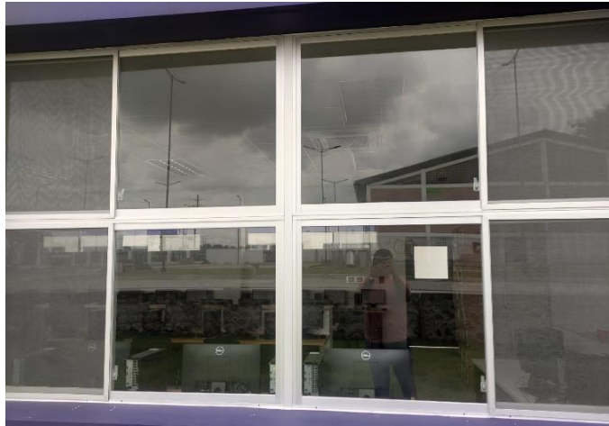
Figura 17 Ventanas sin ninguna seguridad
