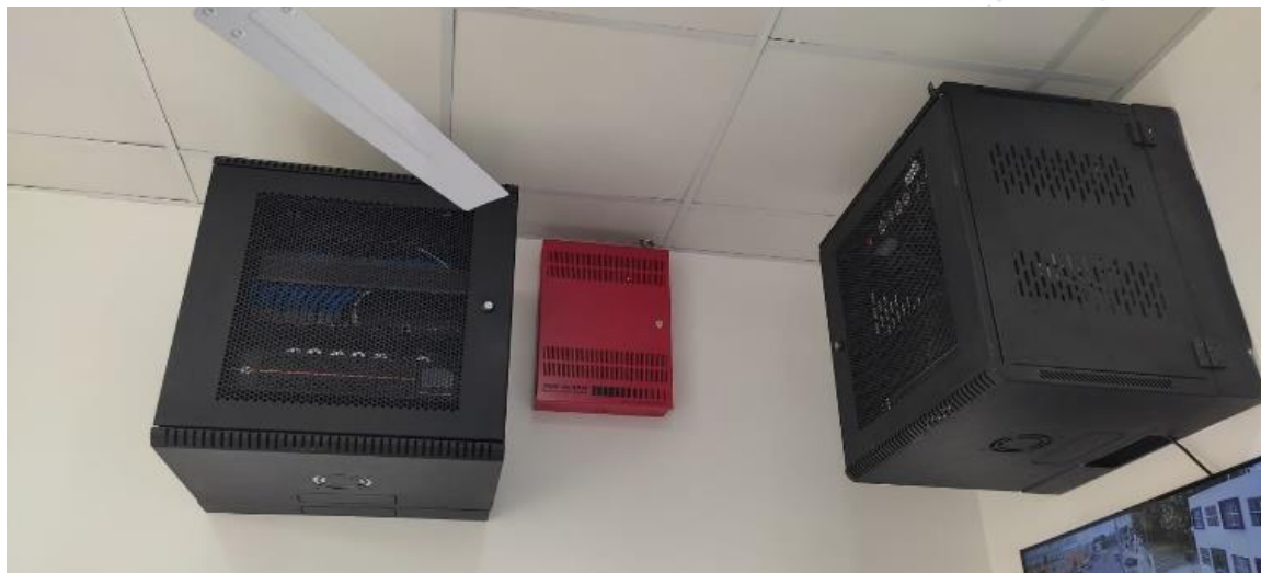
Figura 14 Gabinetes de las camaras de la institución
