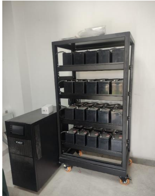
Figura 11 Power bank dentro de la central de datos.
