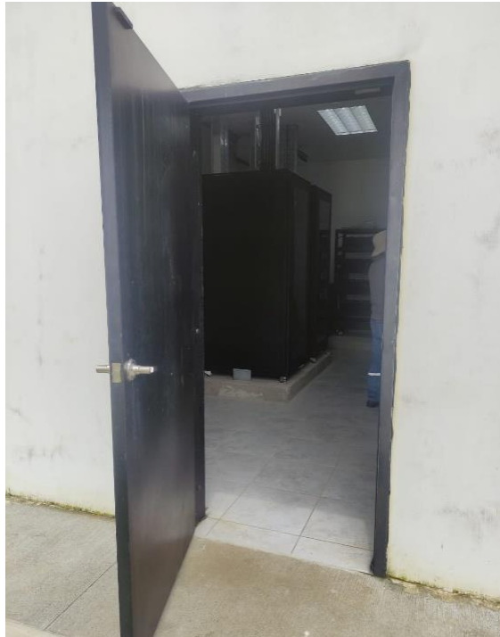
Figura 13 Entrada de la central de datos
