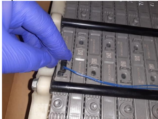
Figura 26 Desconexión de sensor de temperatura
