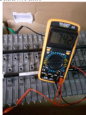
Figura 18 Medición de la tensión individual de cada módulo
