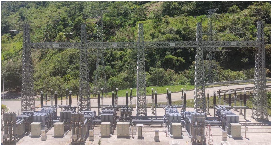
Subestación GIS Delsitanisagua 145 kV
