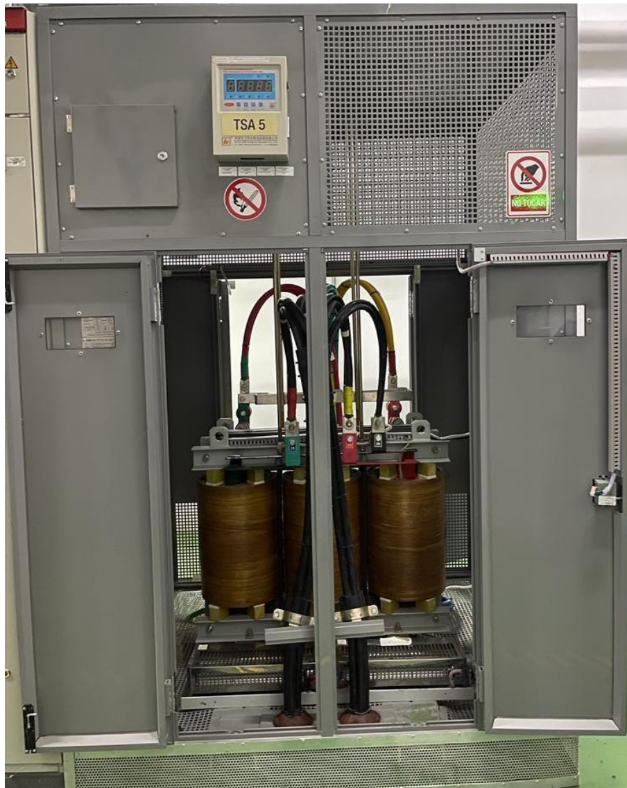
Transformador tipo seco de SSA TSA 5.
