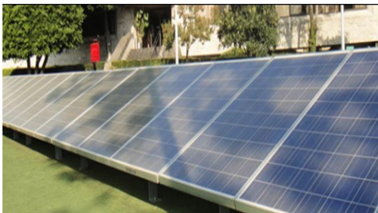
Figura 18. Sombras sobre los paneles solares.
