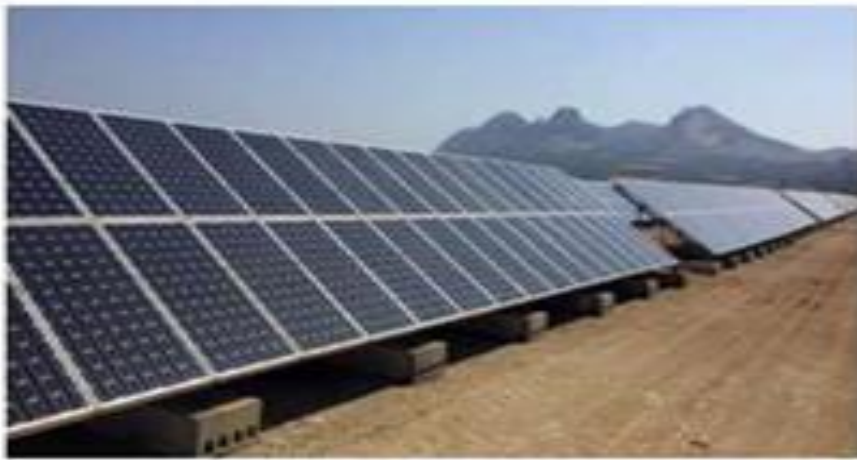
Figura 2. Sistemas fotovoltaicos sobre el suelo.
