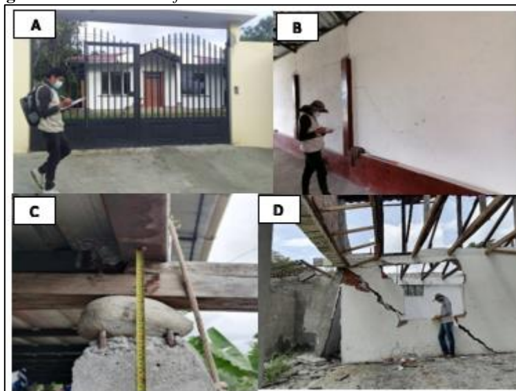
Figura 82. Daños Identificados en las viviendas de San José de las Peñas
