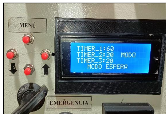
Figura 103. Interfaz del sistema de control de la máquina.
