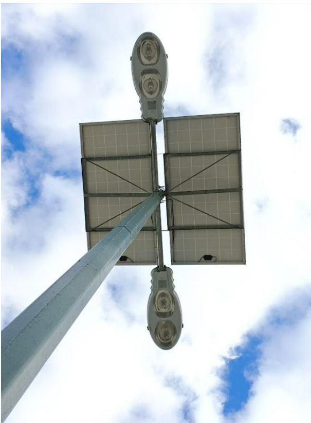
Ilustración 12: Sistema fotovoltaico autónomo actualmente instalado en la Avenida Lateral de Paso Ángel Felicísimo Rojas. | Fuente: Autores
