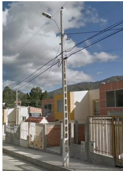
Ilustración 43: Alumbrado con red eléctrica tradicional. | Fuente: Google Maps
