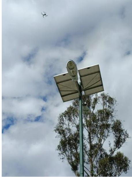
Ilustración 35: Lámparas LED ubicadas en la avenida de integración barrial. | Fuente: Autores
