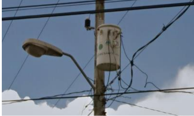
Ilustración 47: Transformado de alumbrado público. | Fuente: Google Maps
