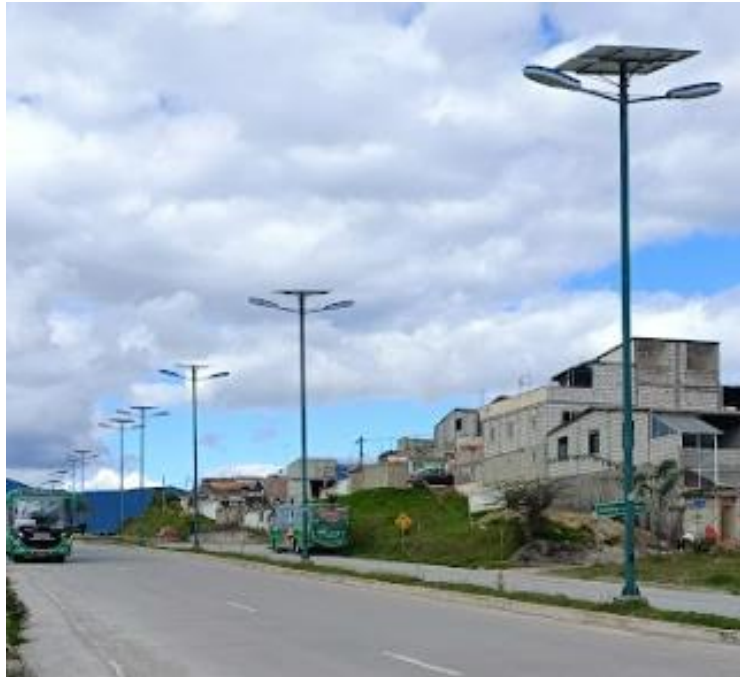
Ilustración 46: Postes de acero actualmente instalados en la avenida de integración barrial. | Fuente: Autores
