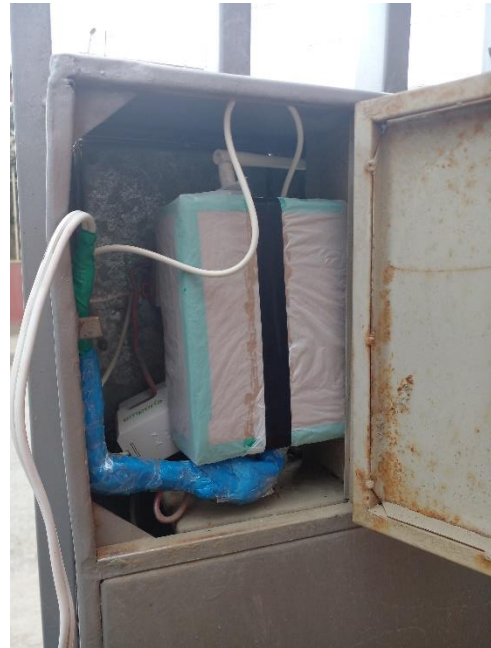
Figura 90. Medidor inteligente instalado en la fachada del usuario # 244655
