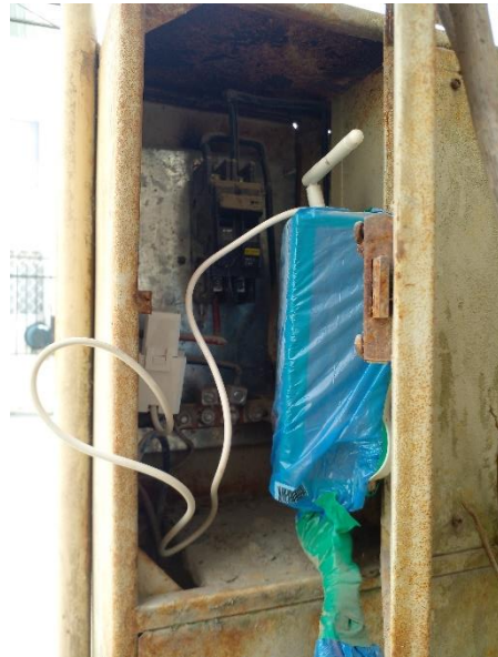
Figura 86. Medidor inteligente instalado en la fachada del usuario # 206359
