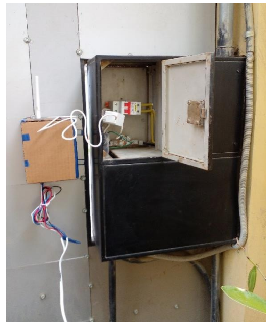
Figura 82. Medidor inteligente instalado en la fachada del usuario # 247396
