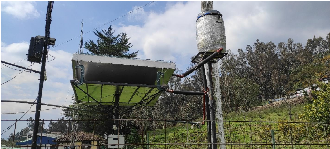
Figura 42. Calentador instalado en la vivienda sustentable.
