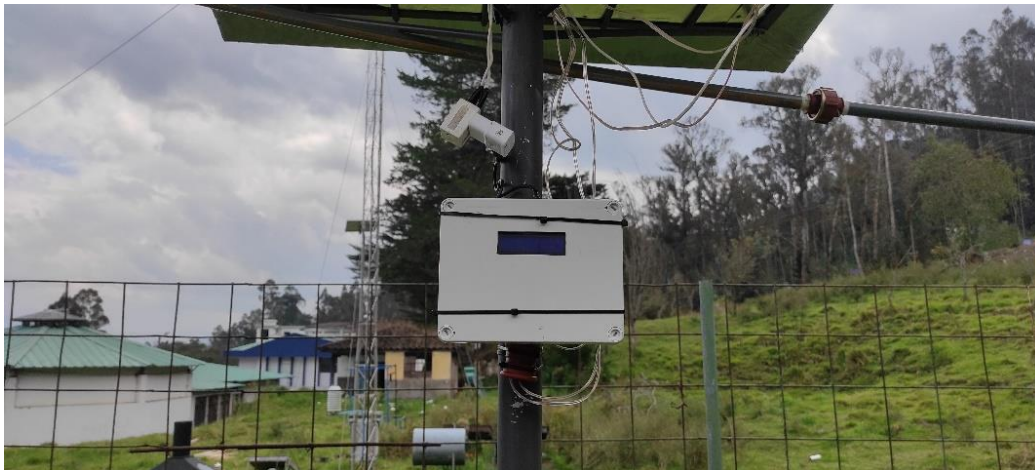
Figura 44. Sistema instalado en el lugar de estudio.
