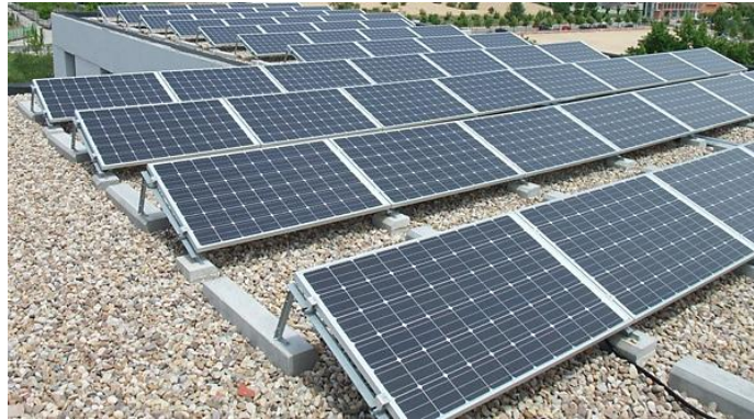
Figura 7. Generadores fotovoltaicos o paneles solares. Autor: (Medioambienteynaturaleza, 2022)
