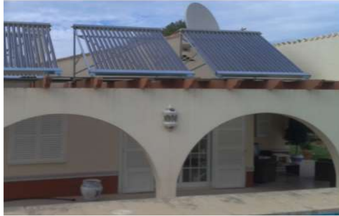
Figura 13. Colector solar de tubos de vacío de flujo directo (Amordad, 2014).
