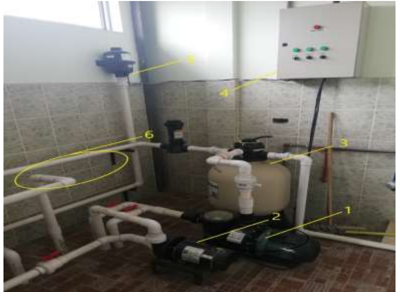
Figura 28. Cuarto de máquinas (El autor).
