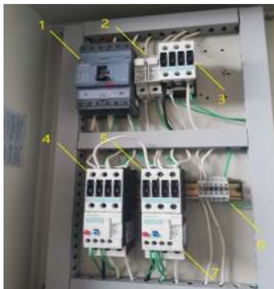
Figura 33. Tablero de control del cuarto de máquinas (El autor).
