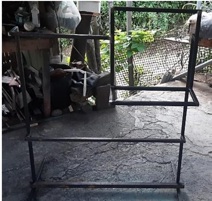
Estructura del banco de cierre centralizado (fase inicial)
