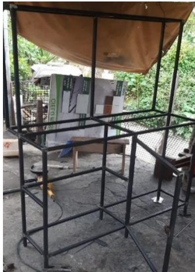
Estructura del banco de luces en su fase inicial
